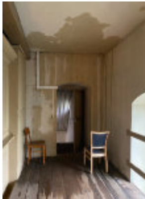
Wasserschaden in der Kirche.
